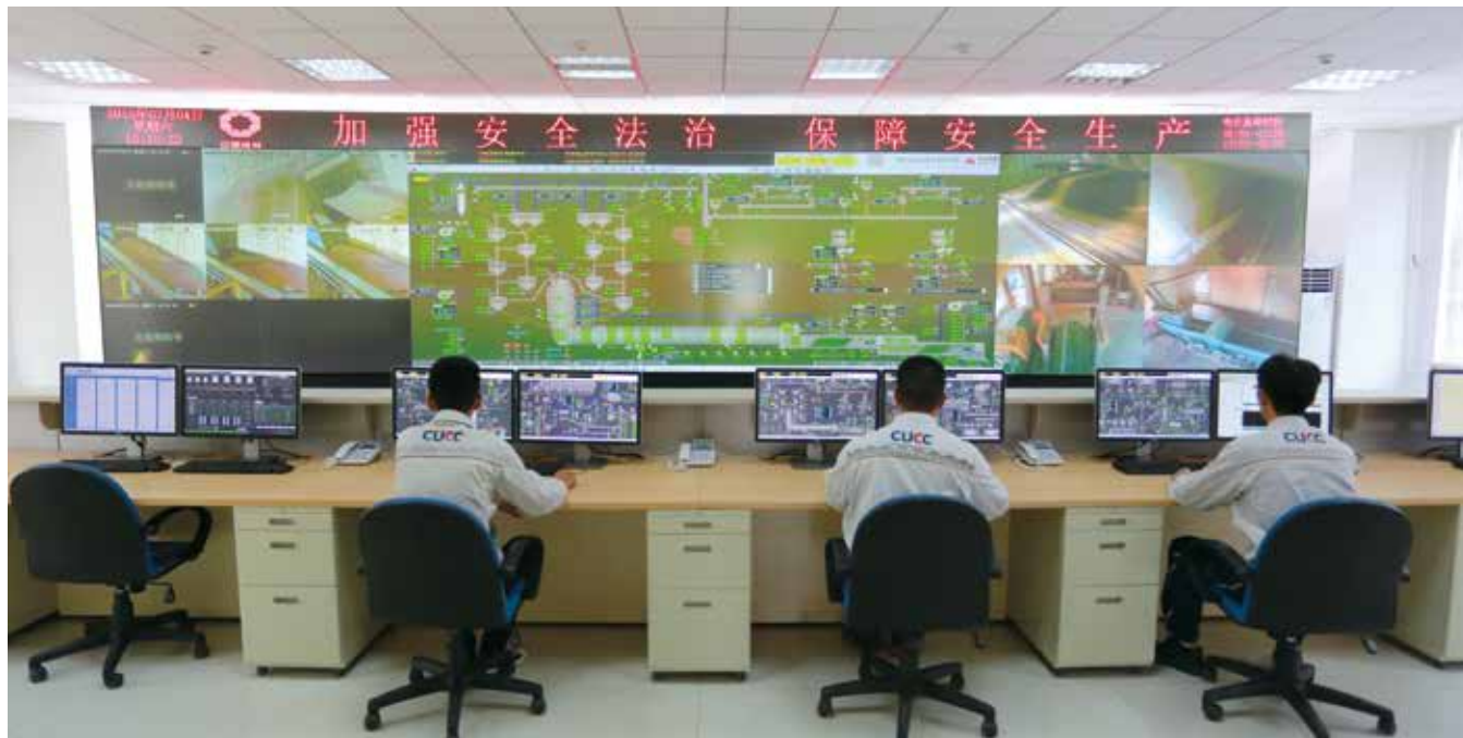
全智能熟料生产线监控调度中心
