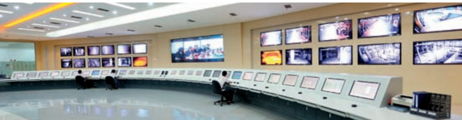
玻纤窑窑总控制室
